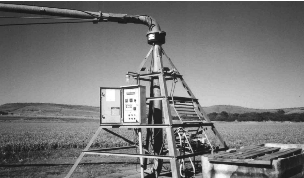
Figura 12.4. Detalle de una bomba centrífuga utilizada para inyección de agroquímicos en un pivot central.
